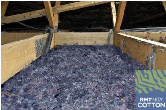
Aïllament de cotó en coberta (Imatge: rmt-nita.es)
